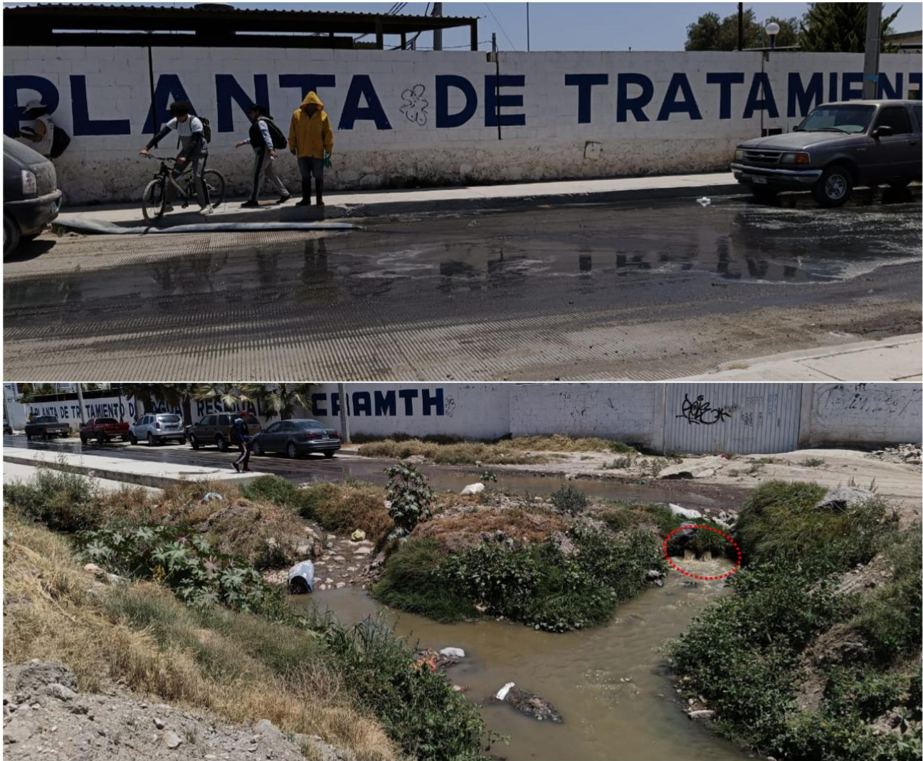
Imagen ECO-B-4. Aguas residuales mal gestionadas.
